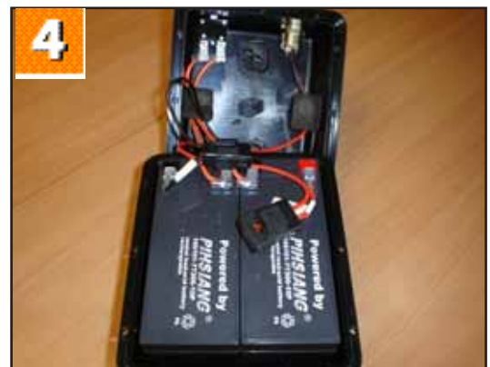
4. The Batteries in situ.
